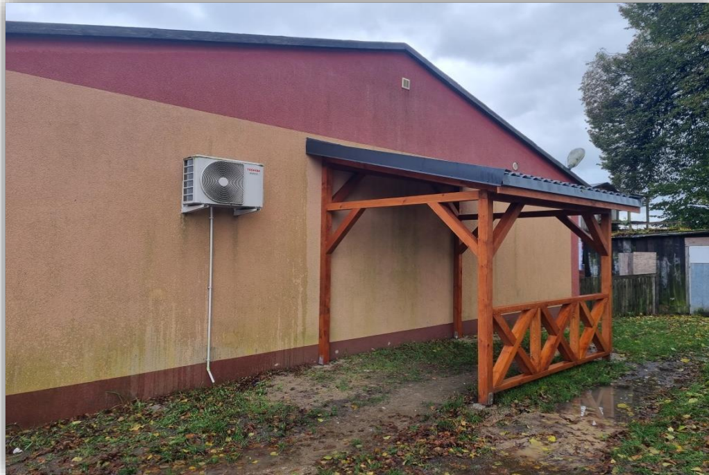
Budowa wiaty rekreacyjnej przy świetlicy w Starym Czarnowie w ramach dotacji o wartości 15 tys. zł z programu „Granty sołeckie”
